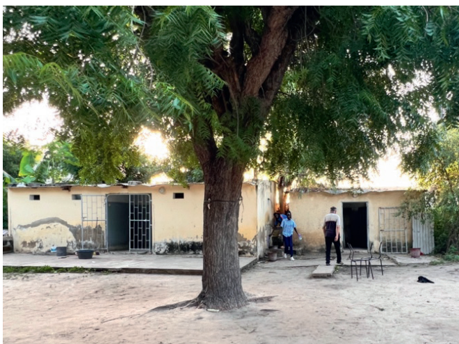
Links für Frauen vier Toiletten und Waschecken, aber ohne Wasser und Strom. Rechts dasselbe für Männer und das für 60 Bewohner
